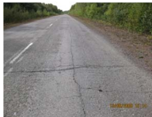
Рис. 1. Линейные отказы асфальтобетонного покрытия – колеи на полосах наката и продольная трещина
